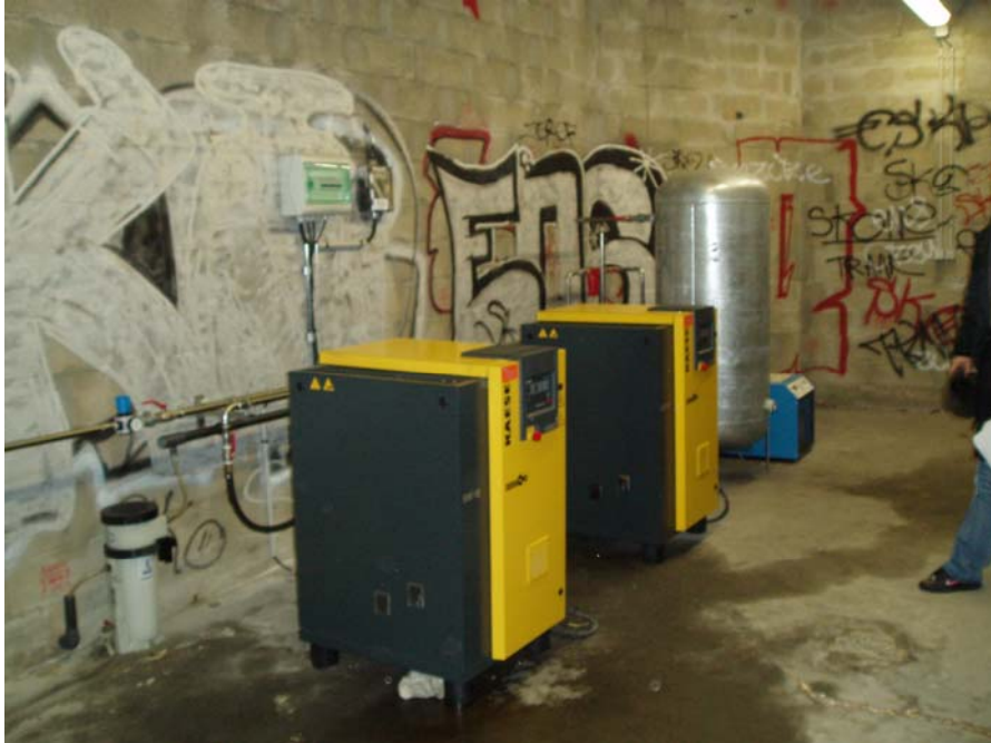
Compresseurs d'air comprimé dédiés à l'aile Erasme
