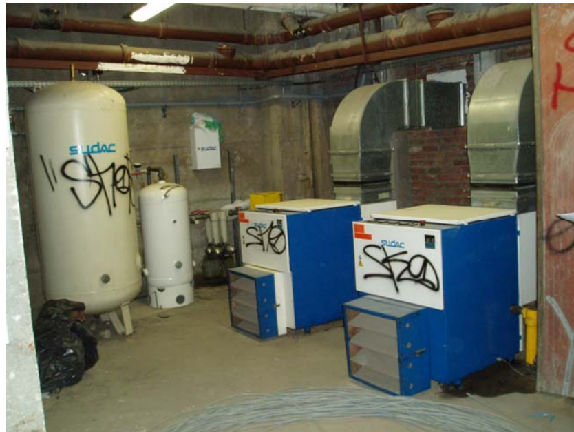
Compresseurs d'air comprimé dédiés à l'aile Lhomond
