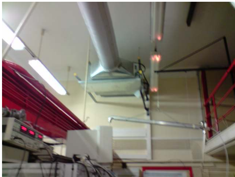
Unité de traitement d'air équipée d'une gaine textile
