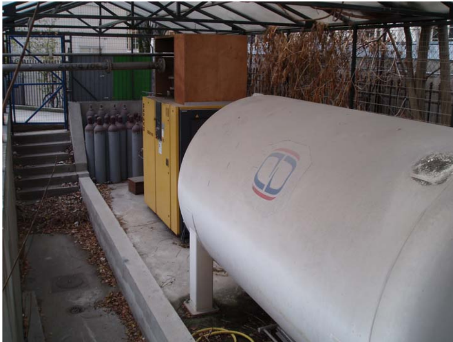
Compresseur d'hélium et cuve de stockage d'azote liquide
