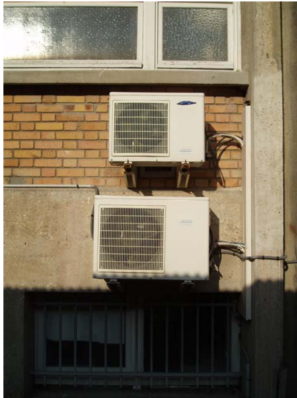
Condenseurs accrochés en façade du bâtiment
