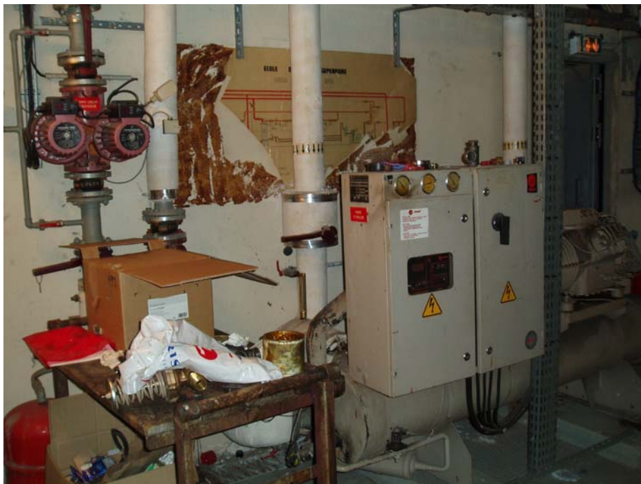
Armoire électrique groupe froid
