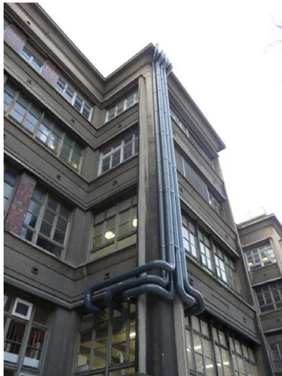
Réseaux de sorbonnes cheminant en façade
