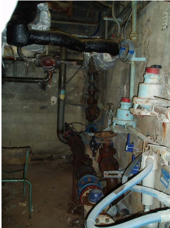
Arrivées générales d'eau froide
