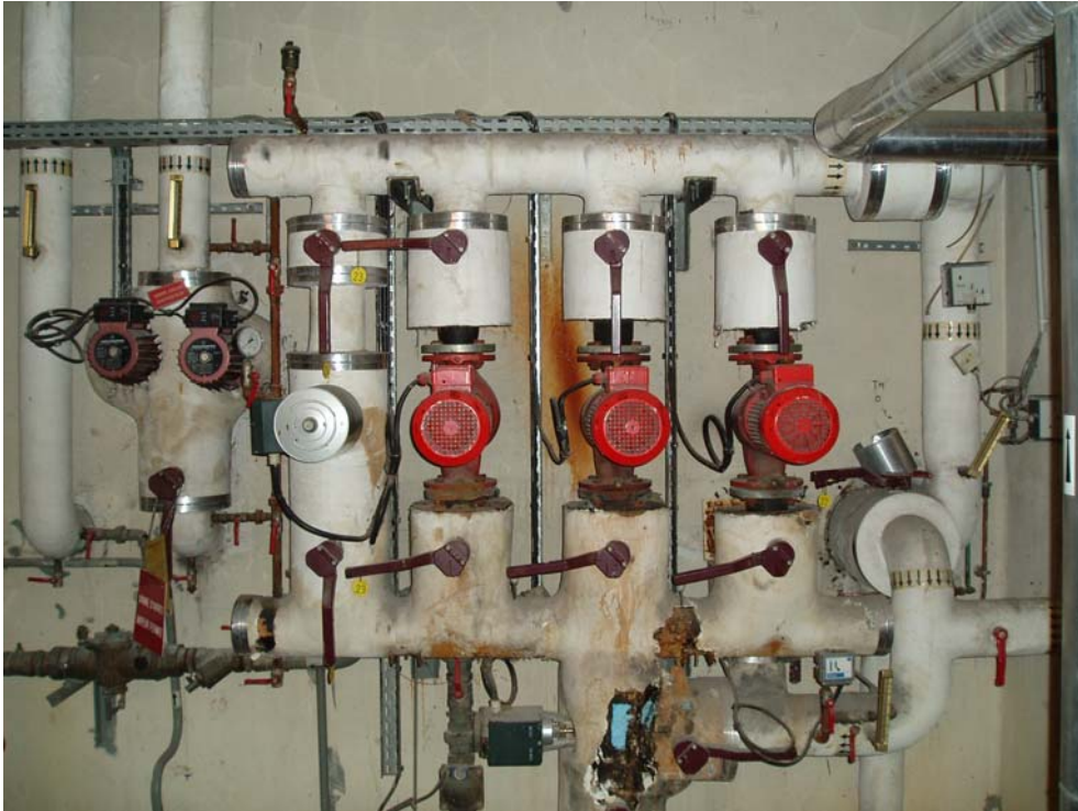
Anciennes pompes du réseau d'eau glacée
